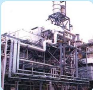
열병합 전용보일러 CO-GENERATION BOILER
